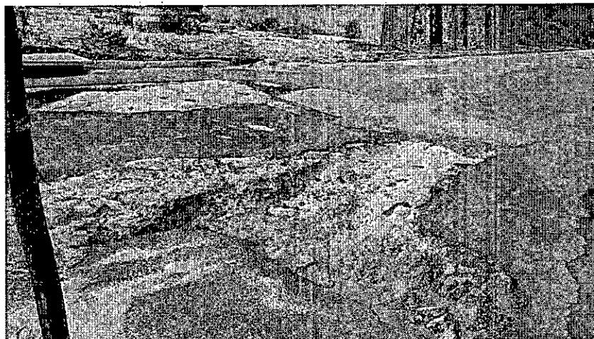
FOTO 21: RUA B, NECESSITANDO DE RESTAURAÇÃO.
